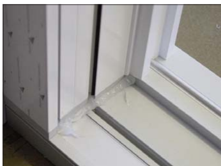
Fig. 2 Sigillatura della soglia con silicone.
