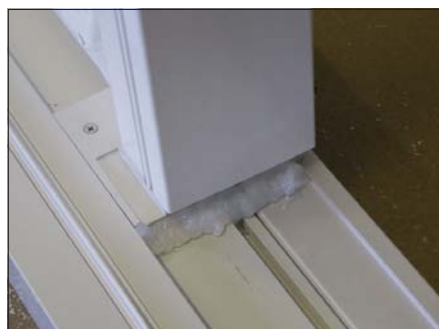
Fig. 1 Sigillatura della soglia con silicone.
