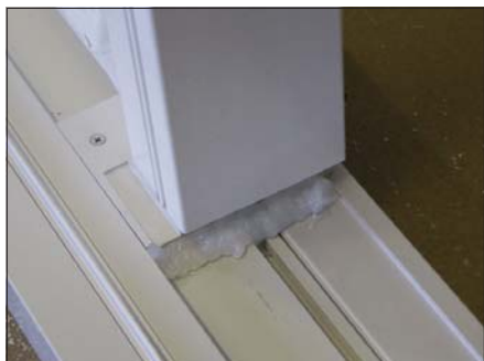
Fig. 1 Sigillatura della soglia con silicone.
